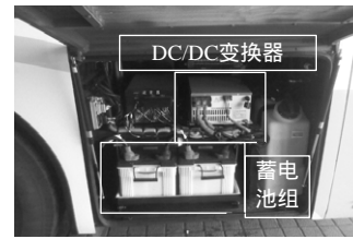
图 8 低压供电装置实物图
